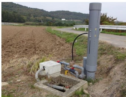
図3 定水位弁を利用した無電源制御装置
